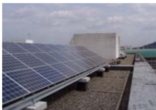
野洲高等学校屋上 県民協働発電施設
