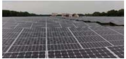
矢橋帰帆島 メガソーラー発電所
